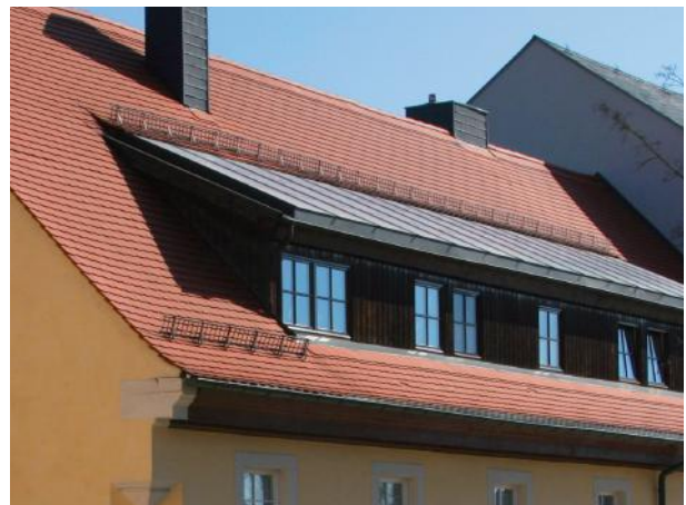
Solaranlage als Indachmontage auf einer Schleppegaupe Quelle: Landesamt für Denkmalpflege Sachsen, Pinkwart
